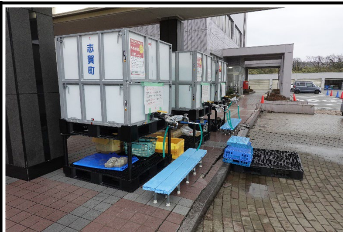
富来行政センターの給水タンク
