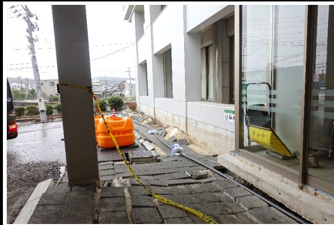
液状化被害を受けた穴水町役場玄関1
