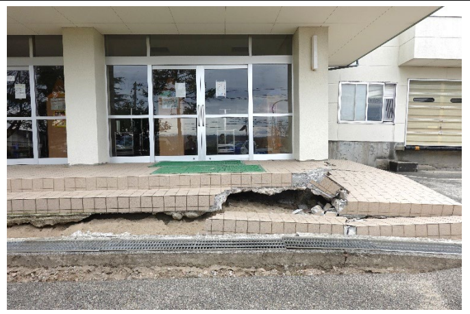
液状化被害を受けた西荒屋小学校玄関2
