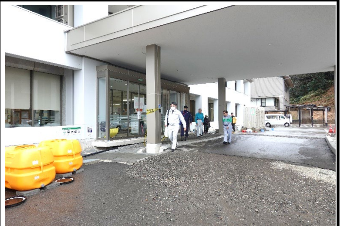
液状化被害を受けた穴水町役場玄関2
