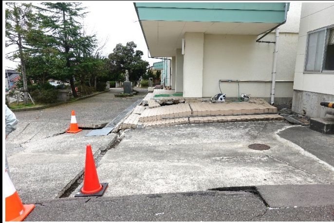
液状化被害を受けた西荒屋小学校玄関1
