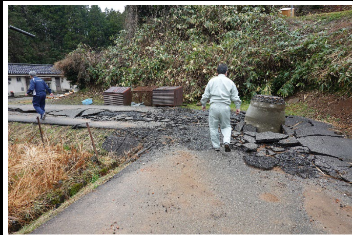
土砂崩れ被害が発生した由比ヶ丘地区3
